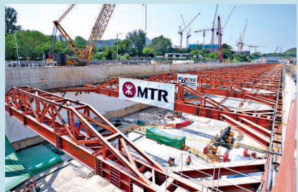
▲北環綫工程率先採用《香港鐵路標準》，有望節省約兩成建造成本。
