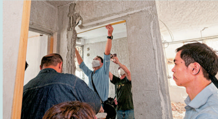
▲宏緻苑懷疑有戶主拆除主力牆，房屋署及管理公司聯合全面檢查。
