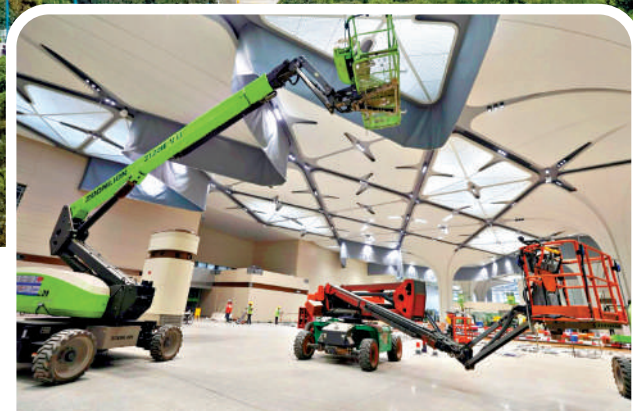
▲目前新皇崗口岸入境驗放大廳已初步完成地面、牆、網頂施工，正進行查驗通道安裝。
