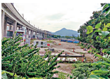
▲新地元朗橋頭圍項目申請改為商住混合發展，佔地約10.71萬方呎。
