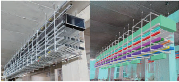
▲古洞站機電裝備合成法。
