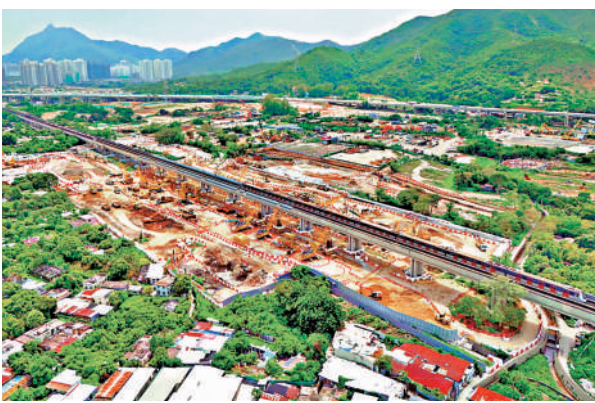
▲屯馬綫洪水橋站採用香港首創的兩種巨型車站模組建造法。
