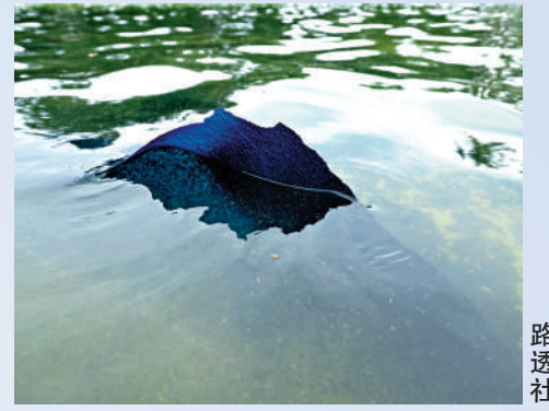
▲6月18日，林肯紀念堂倒影池池底的防水塗層出現脫落。路透社
