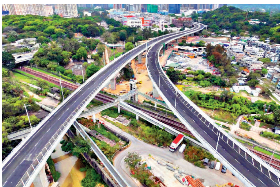
▲粉嶺繞道（東段）在建造階段引入多項創新建造技術與物料，令工期縮短約一年。
