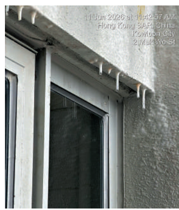
▲啟悅苑有單位滲水至外牆出現「鐘乳石」情況。網上圖片
