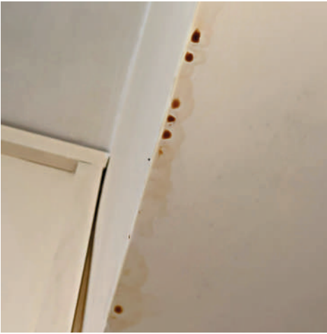
▲田先生家中天花出現疑似鋼筋鏽水。
