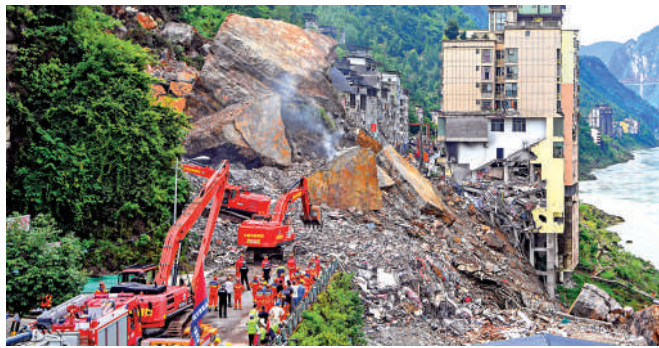
▲重慶彭水山體崩塌，墜落巨石體積大，數量多，救援難度特別大。
