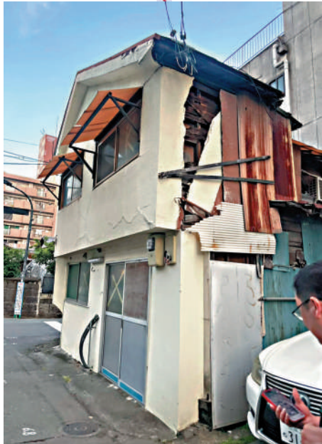
▲熊本縣28日發生7.1級強震，一棟住宅牆體裂開。受訪者供圖
