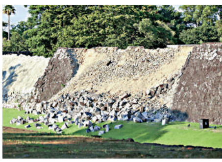
▲熊本城外牆在地震後倒塌。路透社
