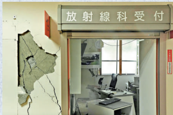
▲熊本縣一家醫院因地震嚴重受損。路透社
