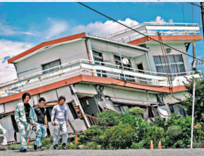
◀地震震動對熊本縣產業造成衝擊。圖為該縣一棟在地震中傾斜坍塌的建築。法新社
