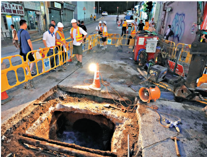
◀筲箕灣道與新成街交界的地下舊水管爆裂，當日工作人員緊急搶修。
