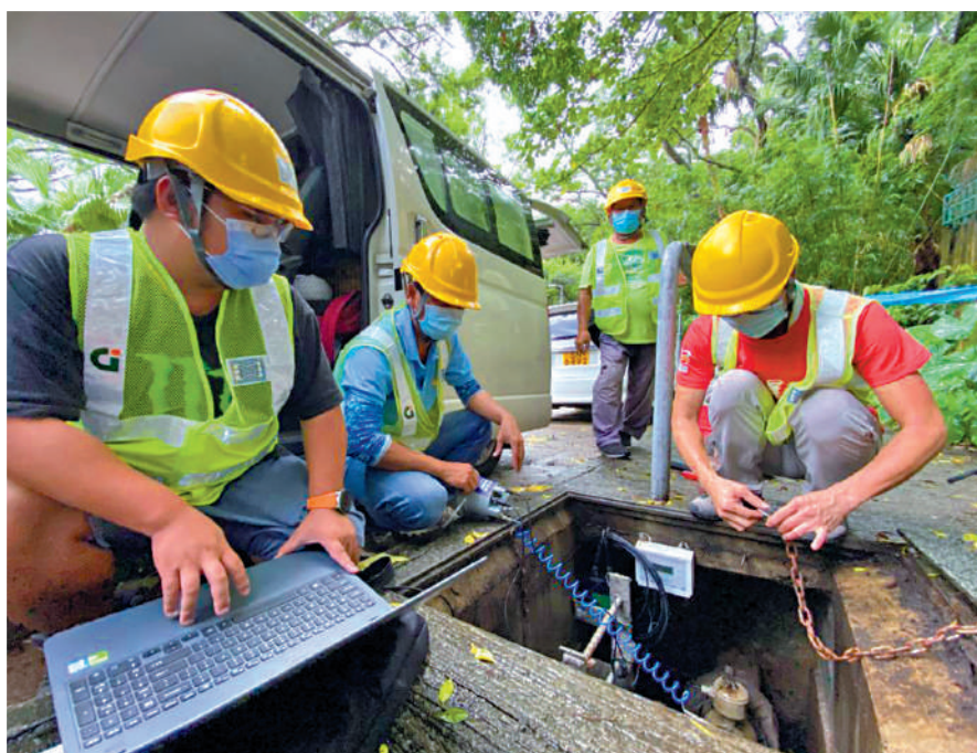
▲水務署透過分析「智管網」所收集的水流量、水壓等數據，監察供水管網是否有出現滲漏的情況。
