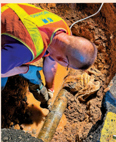
▲筲箕灣及西灣河一帶日前爆食水管，圖為水務署人員加緊搶修水管。
