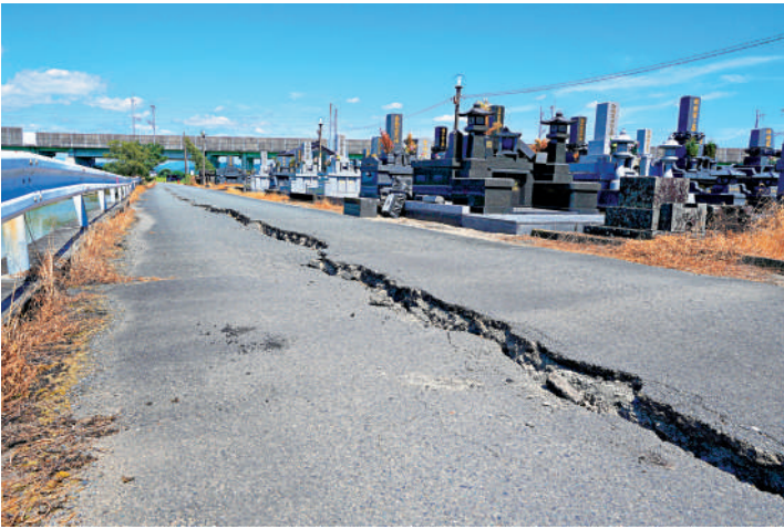
▲地震發生後，熊本縣宇城市一條街道路面出現裂縫。
