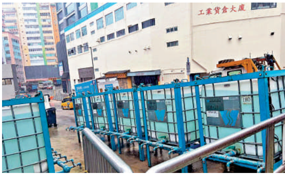
▲葵涌打磚坪街爆水管，設臨時水箱。
