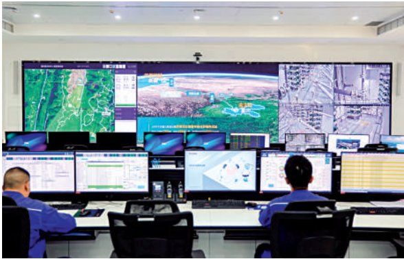
▲7月30日，在「疆電入渝」工程±800千伏渝北換流站，運維人員在開展監盤工作。新華社
