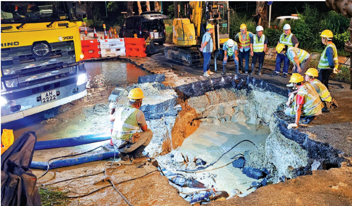
▲屯門青山公路一段食水管近日三次滲漏，須進行搶修。
