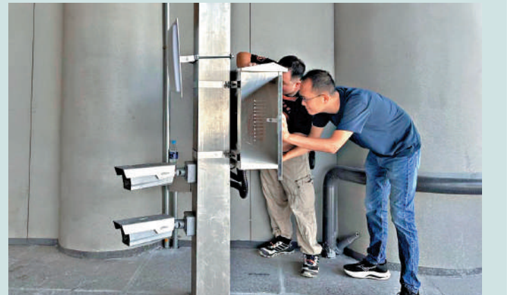
▲運輸署聯同機電署已完成測試落馬洲大橋交通監察系統、公共運輸交匯處乘客資訊顯示系統，以及自動車牌辨識系統等設備。
