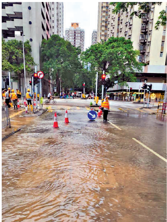
▲大埔安埔路昨日有食水管爆裂，大量食水湧出路面。 區議員羅曉楓圖片
