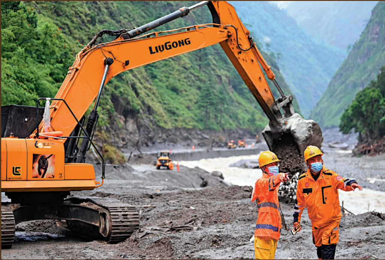
▲8月28日，西藏吉隆泥石流受災路段上挖掘機、裝載機等全力開展清淤保通作業。
