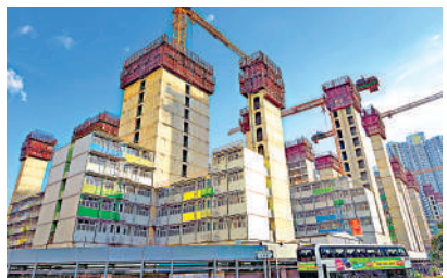
▲承建商安保工程早前被揭在簡約公屋地盤擅自剪螺絲。資料圖片
