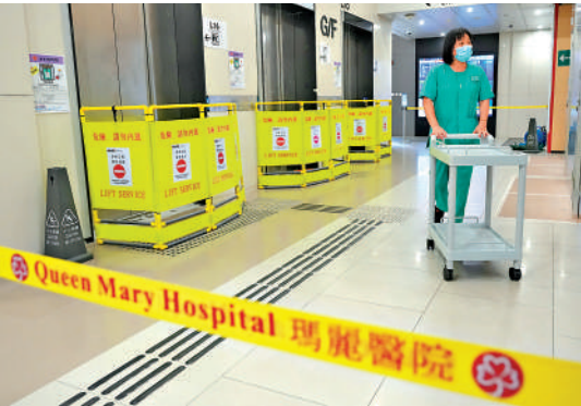
▲瑪麗醫院新臨床大樓內28個升降機展現問題，曾出現只有4部可用的情況。
