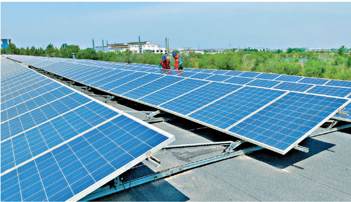
▲中國積極應對全球氣候變化，構建多元化的可再生能源體系。圖為光伏發電設備。 新華社
