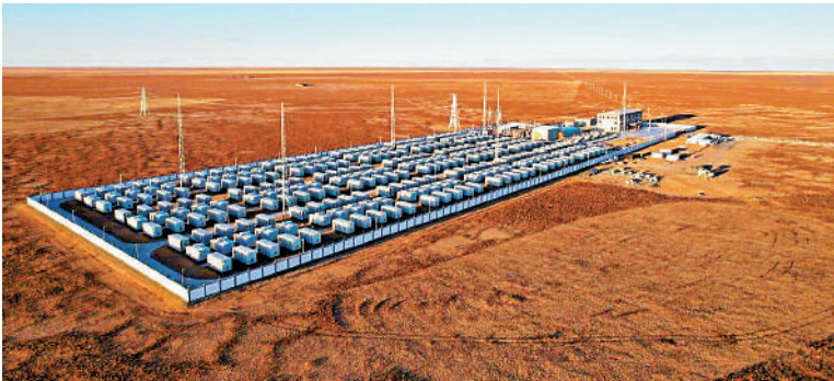
▲贛鋒鋰電儲能電站。
