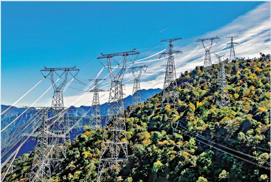
►新型電網建設持續推進西電東送戰略布局，國家電網川渝1000千伏特高壓交流輸電工程前年底投運。 網絡圖片
