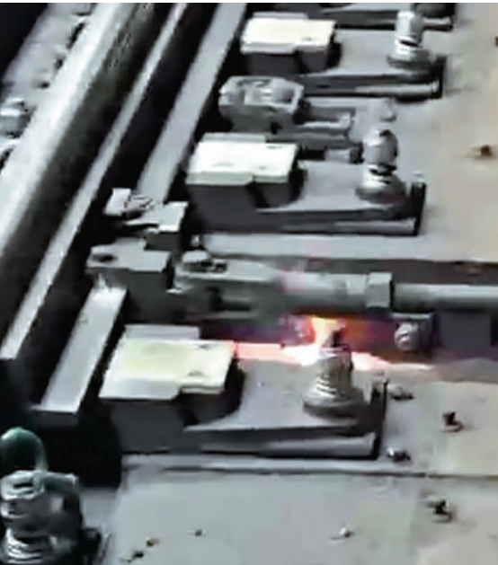
▲港鐵藍田站路軌旁疑有道岔設備絕緣膠因短路起火。港鐵圖片
