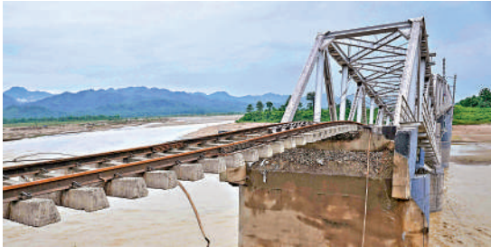
▲印度阿薩姆邦德拉傑一條鐵路橋因為洪水受損。
