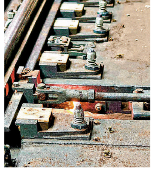
▲本月中，港鐵藍田站路軌旁懷疑道岔設備絕緣膠因短路起火。資料圖片
