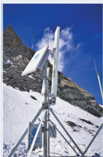
▲ 珠峰海拔6,500米前進營地上的5G基站。 中移動圖片
