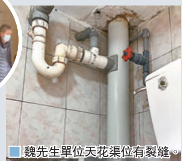
魏先生單位天花渠位有裂縫。
