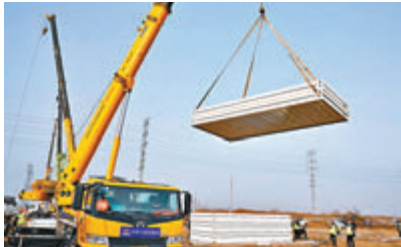
●昨日，工人在石家莊市集中隔離點建設工地吊運集成房屋材料，3,000套集成房屋正由唐山市陸續運抵正定縣。
