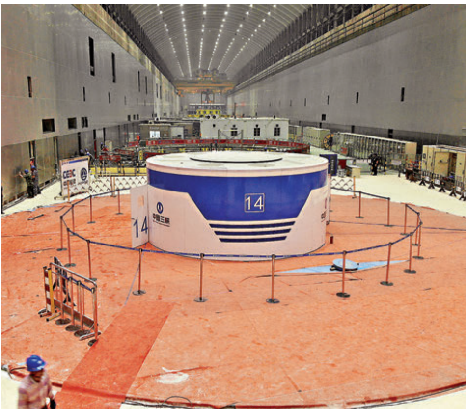
●白鶴灘水電站右岸廠房，全球首台百萬千瓦水電機組。
