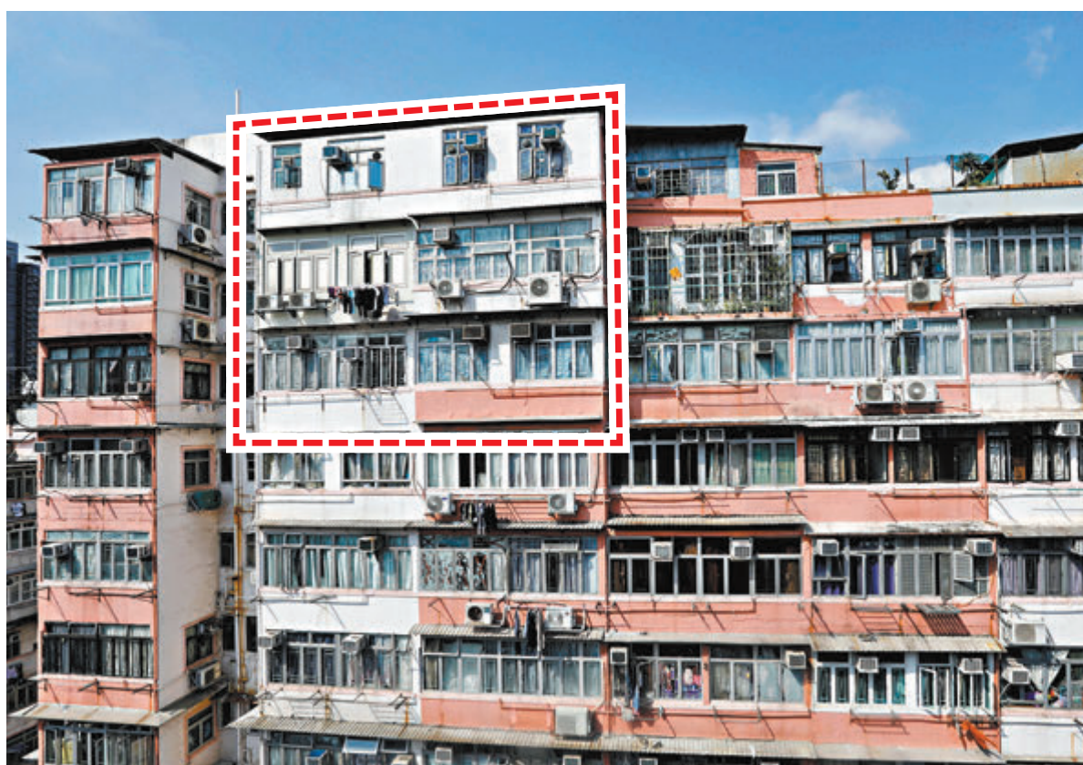
●龍華大廈逾20名業主收到屋宇署命令，指他們的單位有僭建物，勒令還原。因原本樓頂是斜面呈梯形，後被人「僭建」成平頂，紅框樓層明顯比鄰近樓層凸出。香港文匯報記者 攝
