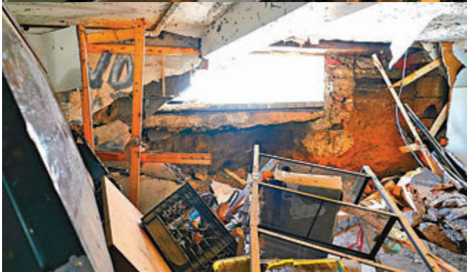
▲洪水從窗戶湧入地下室。
