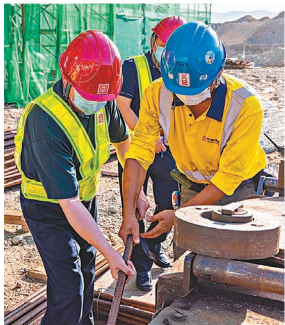
●譚鐵牛副主任(左)在地盤施工現場向工友學習紮鐵。 中聯辦網站圖片
