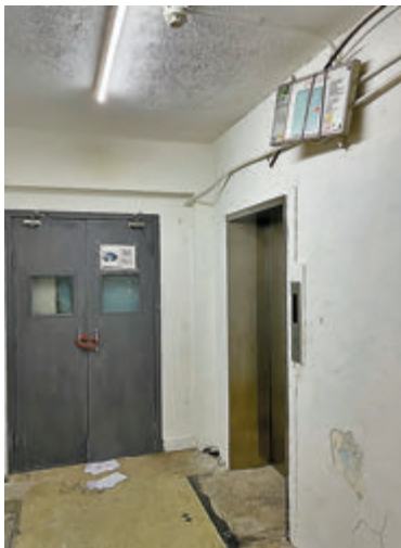
●有樓層防煙門竟然用鐵鏈鎖上。
