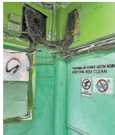
●電線亂搭亂飛，火災危機四伏。
