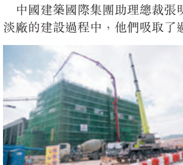
●將軍澳海水化淡廠預計2023年完成。圖為將軍澳海水化淡廠一期興建項目。
