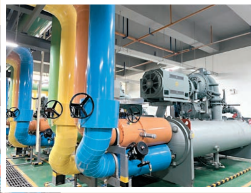
灃西能源公司的供熱機房。
