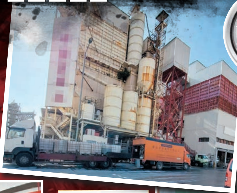
◆「奶媽車」位於油塘工程地盤旁邊，一旦起火，後果嚴重。香港文匯報記者 攝
