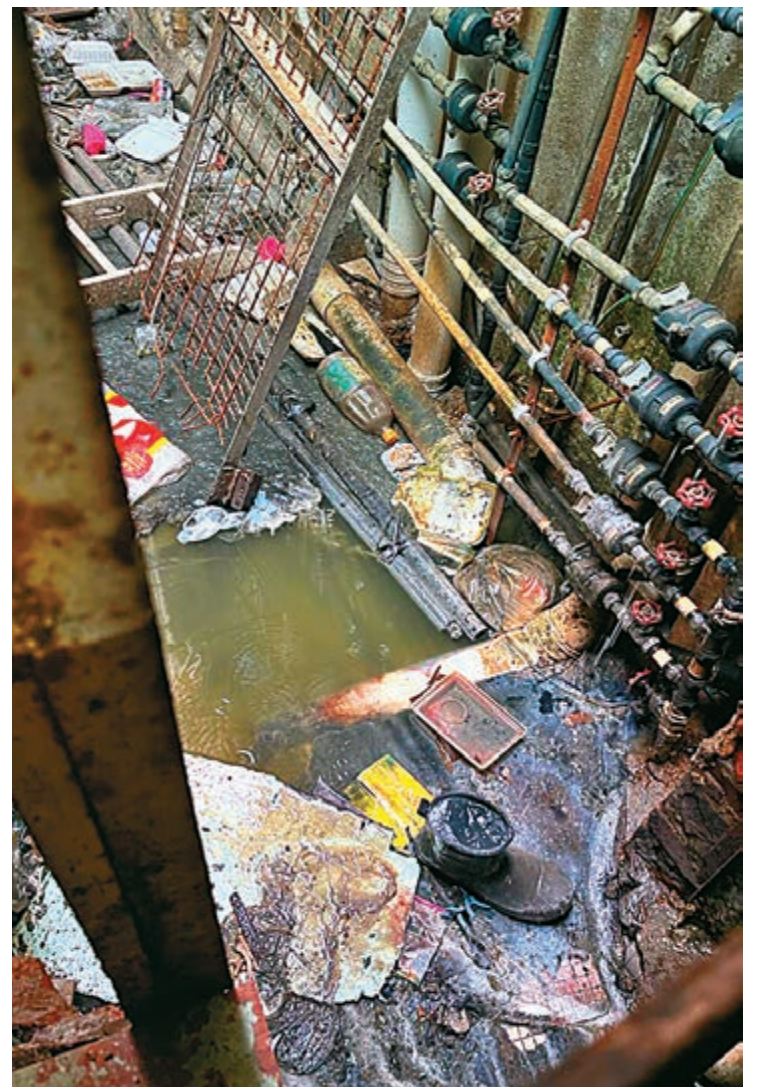
◆深水埗樓宇渠管破裂污水四溢情況嚴重。 受訪者供圖
