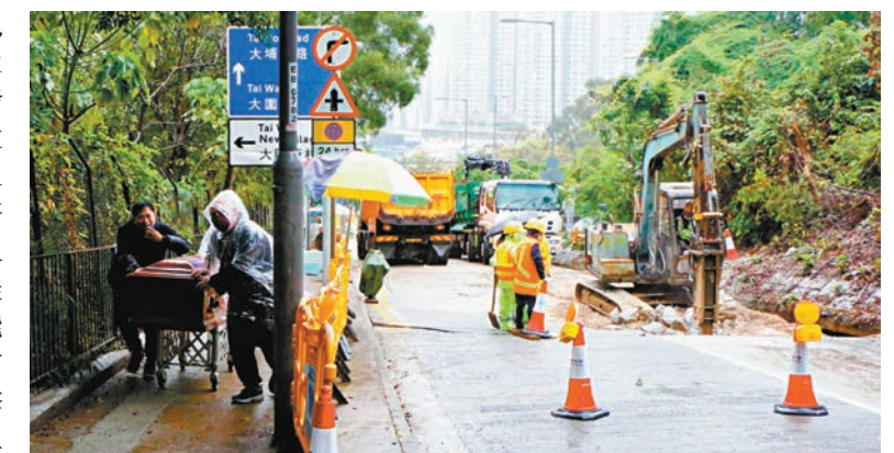
大圍下城門道路陷，工人冒雨運送靈柩至靈車。香港文匯報記者攝
