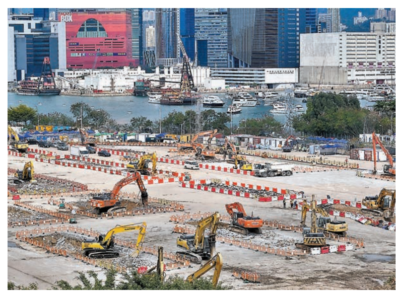
◆啓德郵輪碼頭頭地盤，幾十部挖機同時開工，趕建方艙醫院。香港文匯報記者 攝
