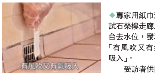
專家用紙巾測試石榮樓走廊地台去水口，發現「有風吹又有氣吸入」。受訪者供圖
