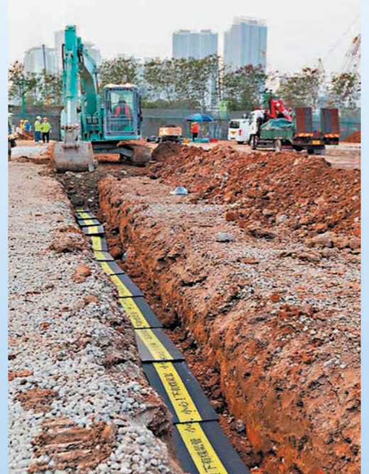
◆中華煤氣為鋪設長達1.5公里的煤氣管線，200人4天來通宵在工地工作。
