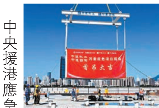
◆3月19日，中央援港應急醫院建設項目一期1,545個集成式箱體全部吊裝完成。圖為在9日完成首個集成式箱體吊裝。
