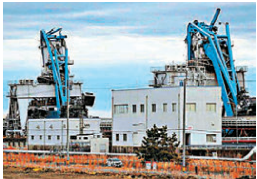
◆福島新地發電站部分設備嚴重損壞。
