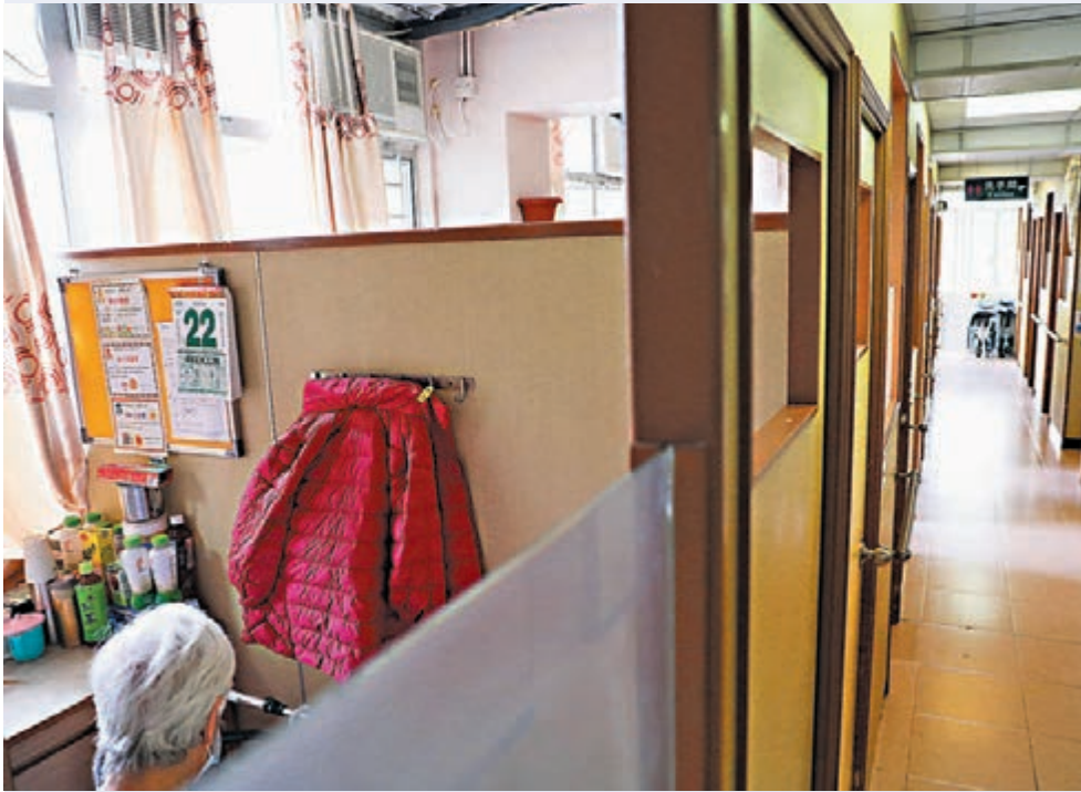
◆院舍房與房之間隔板並未伸延至天花，染疫院友排出的空氣可散播到走廊。香港文匯報記者 攝
