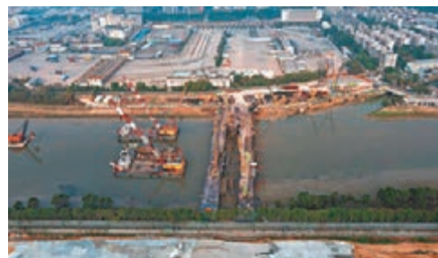
◆3月5日，工程人員在深圳河上完成臨時鋼棧橋搭建，連通深港兩地，為大規模施工提供了先決條件。
