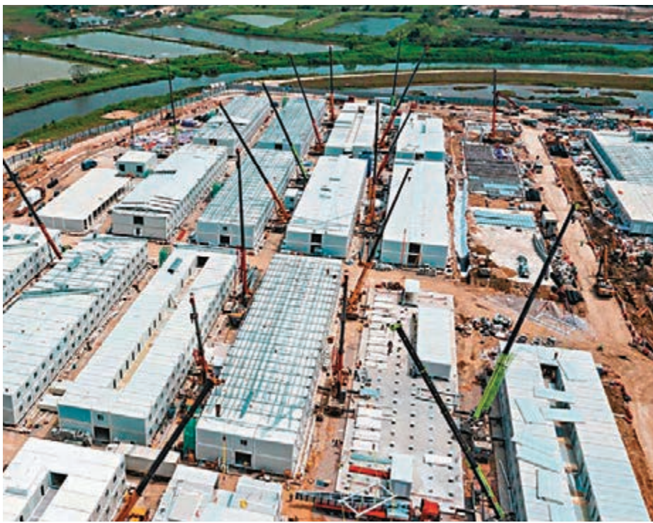
◆位於香港落馬洲河套地區的中央援建香港應急醫院項目一期正式進入聯調聯試階段。圖為工程人員於3月19日完成一期病房全部1,545個集成式箱體吊裝工作。
